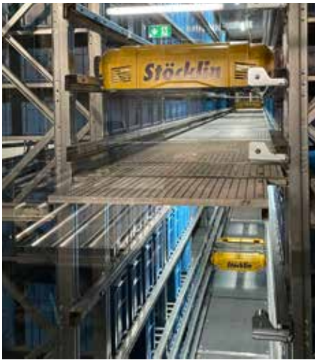
Shuttlelager mit 3580 Boxenplätzen und 28 Shuttlefahrzeugen bei Stöcklin Logistik AG in Laufen.
