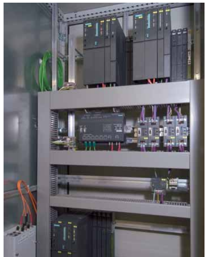
Blick in den Schaltschrank der Allegro-Tanksteuerung: redundante Allegro-Steuerung Simatic S7-417H (oben), Ethernet OSM TP62, Profibus-Repeater für ET 200M Anschaltungen und redundant angeschaltete Operator-Panel (Mitte) sowie Batch-Steuerung S7-417 (unten).
