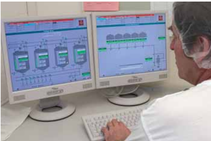
Leitstelle für das Tanklager Allegro im Teamleiterbüro. Visualisiert wird im Rahmen von PCS 7/ Batch mit Windows Control Center (WinCC) von Siemens Automation and Drives.
